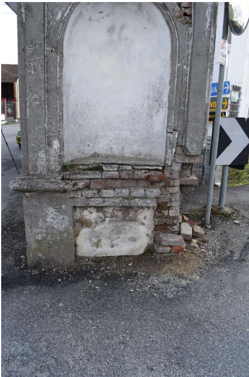
Foto 11 – Dettaglio mancanze poste sull'angolo inferiore del fronte nord-ovest
