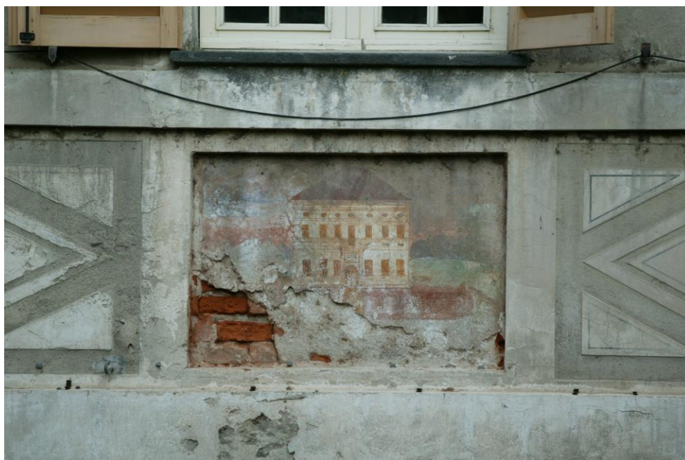
Particolare del degrado del dipinto posto sulla facciata principale
