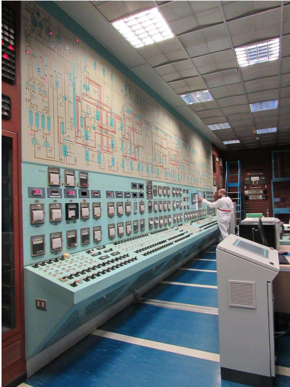
Sala Controllo Impianto Eurex di Saluggia – Fonte SOGIN
